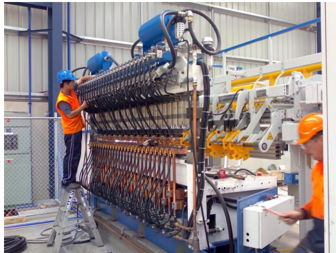
Gebraucht-Gitterschweissanlage von Schlatter nach der Revision:
