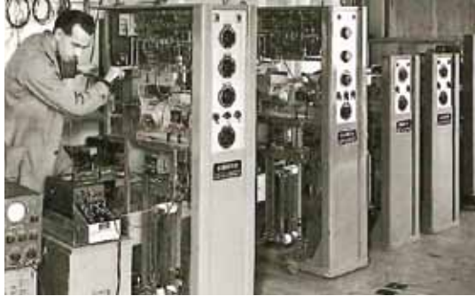
Contrôle des appareils de commande « Variotron »
